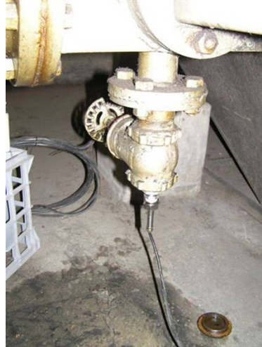
b) Cooler Return Pipe
