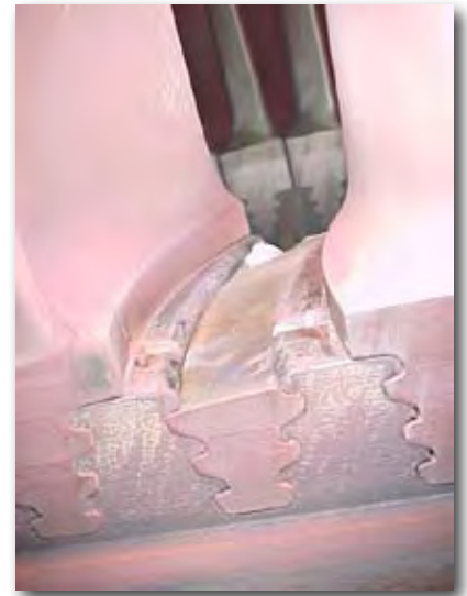
稼動中の羽根付根の完全破砕
