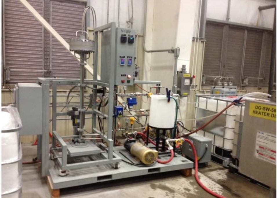
Figure 3-1 VSEP pilot unit
